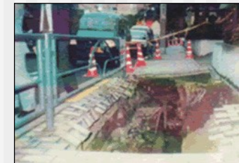
道路陥没写真
