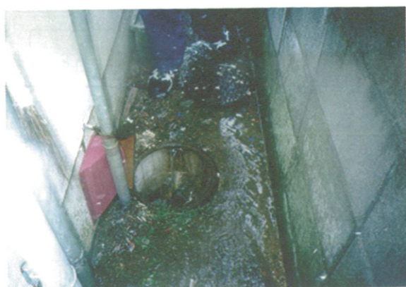
写真-2 汚水マスに穴を開けた事例
