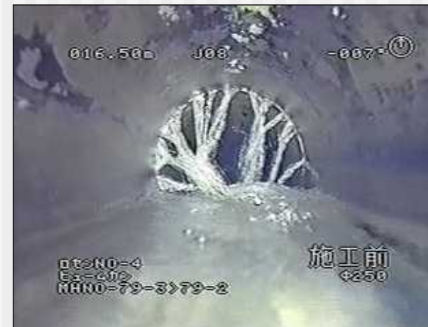
浸入水がもたらす管路施設の劣化
