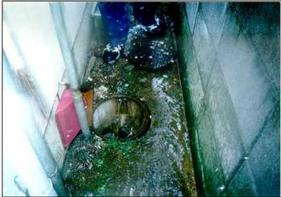
汚水桝に穴を開けた事例
