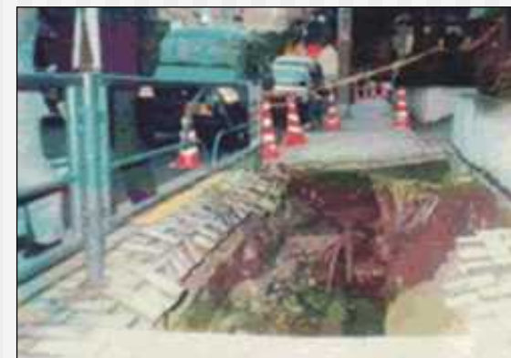
道路陥没写真 国土交通省HPより
